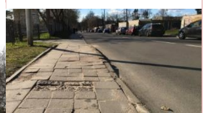
Atnaujinta gatvės danga, tačiau paliktas netvarkingas šaligatvis.
